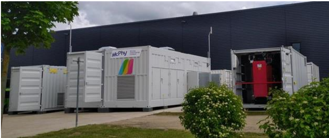
2 MW d'électrolyse grande puissance McLyzer par McPhy | Apex Energy, Laage, Allemagne
