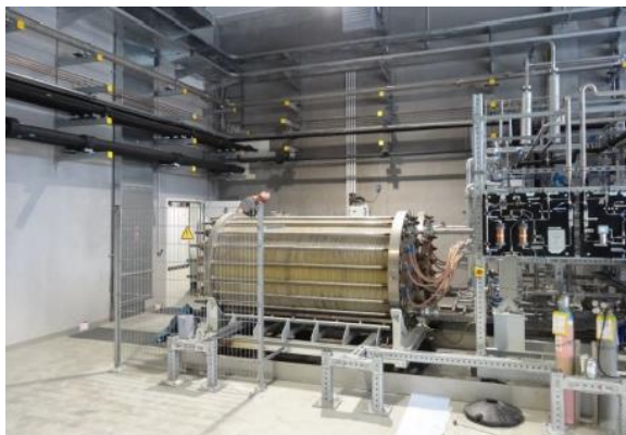
Photo de l'électrolyseur après l'incident
